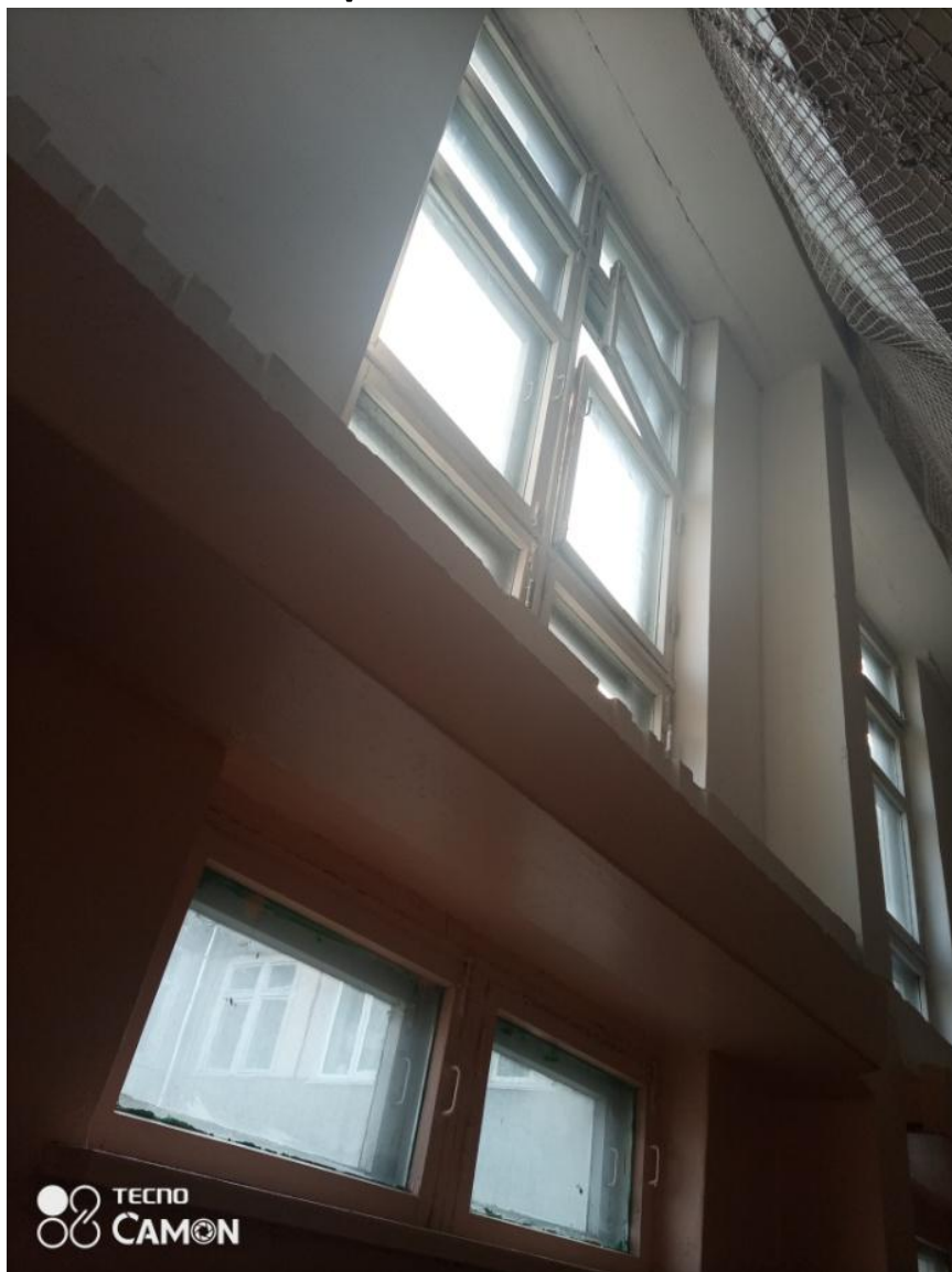
окна спортивного зала до ремонта
